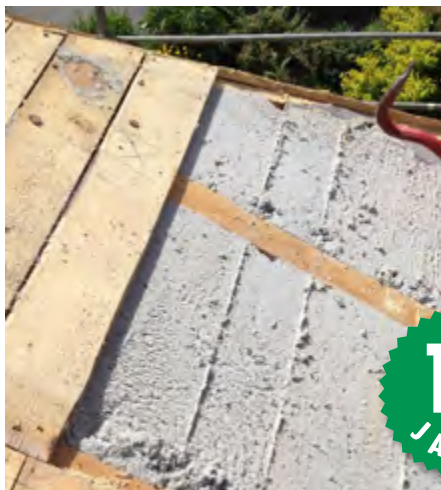
Nach 17 Jahre geöffneter Dachstuhl: Dämmstoff Zellulose wirkt wie frisch eingeblasen...
